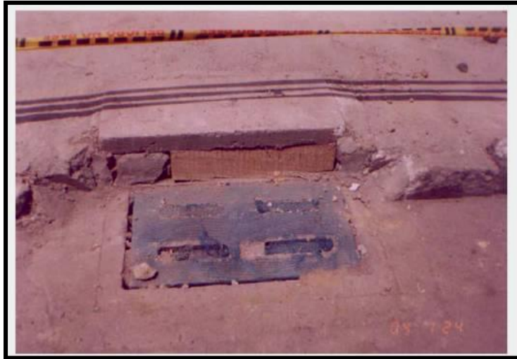
Figura 8.20 Protección de sumideros
